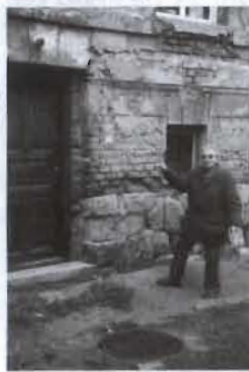
Ściana frontowa budynku, przy której Becker rozstrzeliwał swoje ofiary. Autor artykułów pokazuje ślady po kulach.
